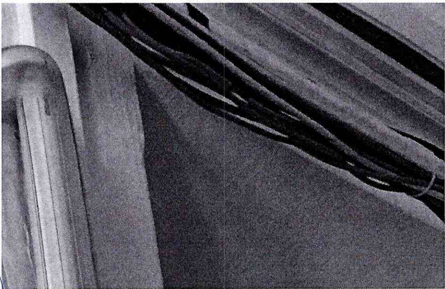
Fotografía N° 2 Ausencia de canaleta de protección
