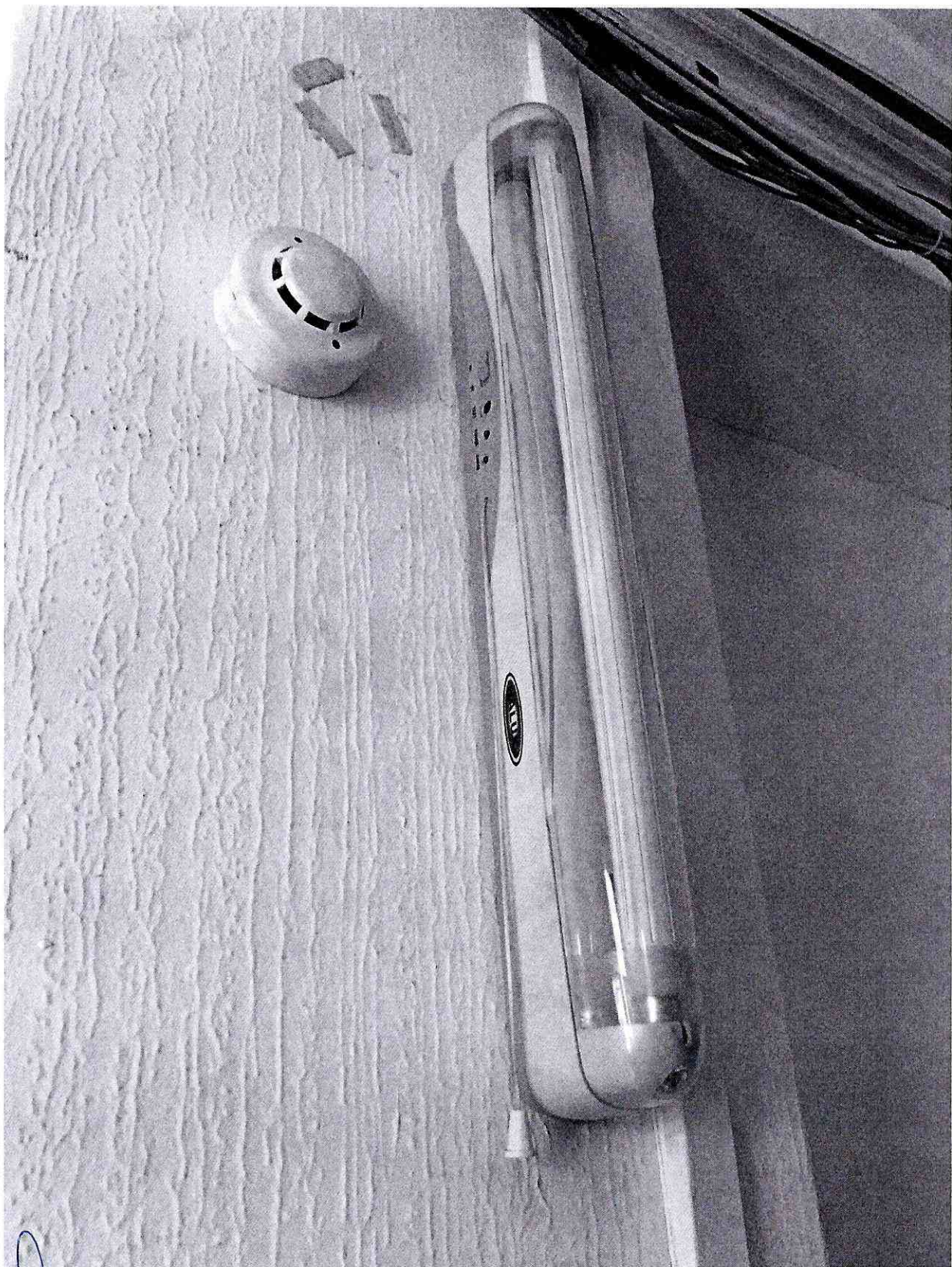
Fotografía N° 11 Detector de humo y luces de emergencia.
