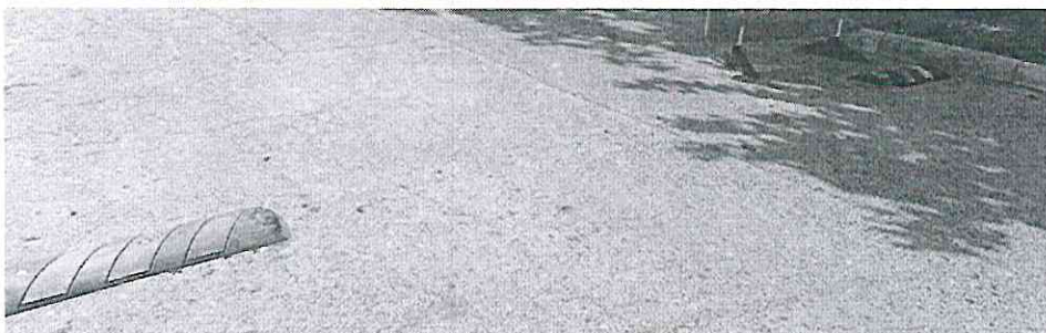
Fotografía N°2: Resalto en mal estado en Vasco de Gama.
